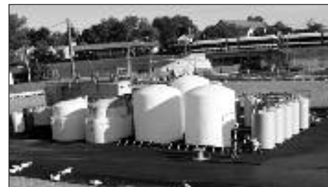
Sistema de tratamiento de agua localizado en la porción del sitio de Garfield Avenue donde se excavaron y retiraron los residuos de cromo.
